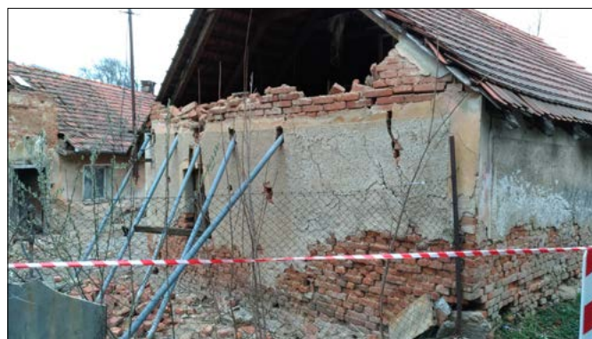
Stav stodoly v únoru tohoto roku po zhroutilí vršku štitové zdi
