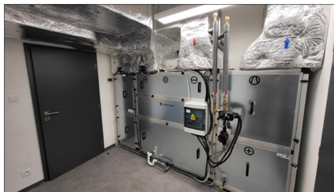
Vzduchotechnika s rekuperací pro obecní část budovy.
