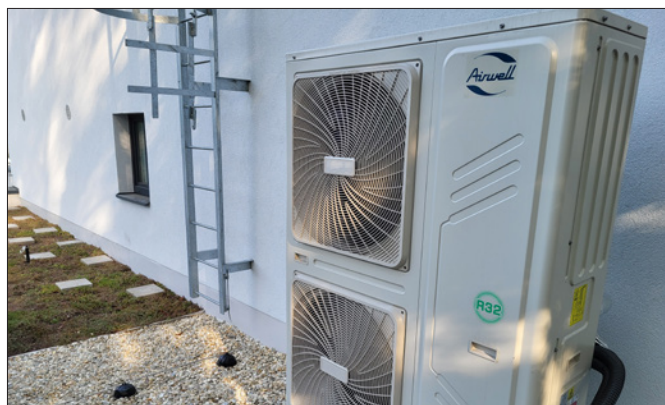
O vytápění a přípravu teplé vody se stará dvojice tepelných čerpadel.
