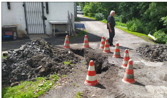
V prostoru za budovou fotbalového klubu se propadla vozovka. Stalo se tak díky netěsnosti odpadní trubky vedoucí z kuchyně do potoka. Tato nepovolená výpust byla následně zaslepena.
